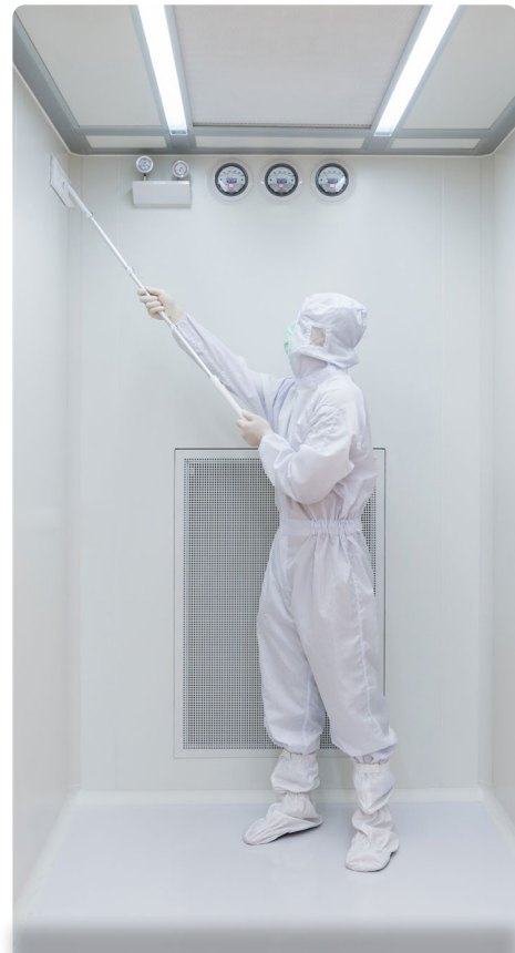
Salle blanche & de confinement
